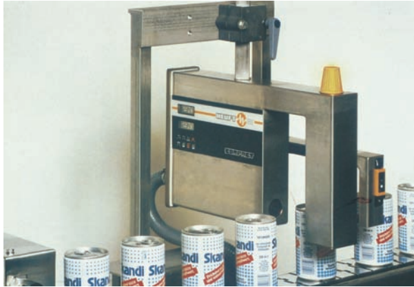
FIG. 71. Exemple typique de jauge de niveau ( ^{241}\text{Am} ) montée sur une chaîne de remplissage (photographie : NRC).
