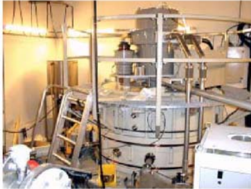
FIG. 9. TT1000 Final Amplifier: Rhodotron.
