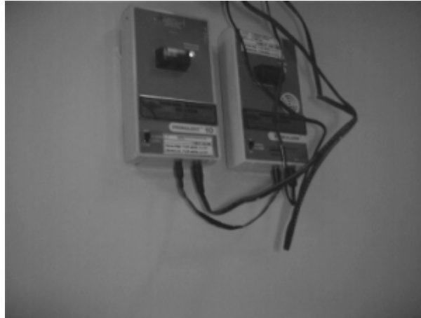
Figure 6 Las conexiones Eléctricas deficientes o expuestas a la fácil manipulación por personas inexpertas, pueden provocar funcionamiento errado y por ende la interrupción de la detección de las radiaciones ionizantes.
