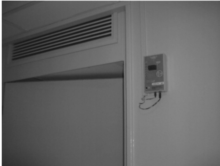
Figure 2 Puerta de ingreso a la sala de hospitalización con su dispositivo de alerta temprana ubicado a un costado
