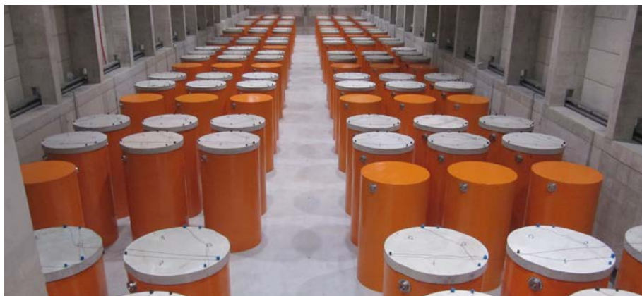
РИС. 23. Сухое хранение в бетонных транспортно-упаковочных контейнерах CONSTOR на Игналинской АЭС, Литва (публикуется с разрешения ГП «Игналинская атомная электростанция»).
