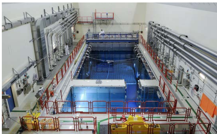
РИС. 63. Внутренний вид бассейна выдержки ОЯТ на ККГ, Швейцария.
