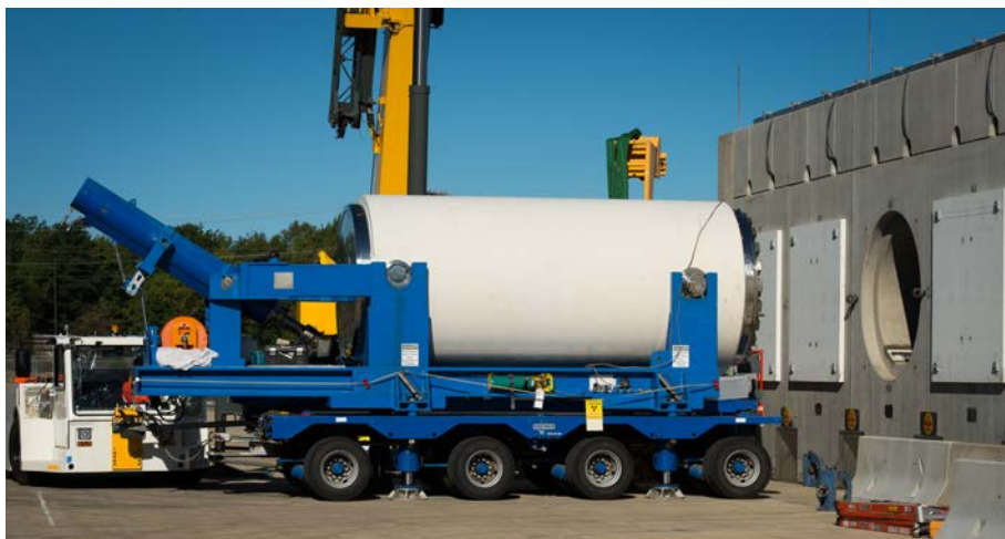
РИС. 37. Загрузка пенала в горизонтальный бетонный модуль (система NUClear HOriZontal Modular Storage компании «Орано», известная как NUHOMS, «ТН Америкас»).
