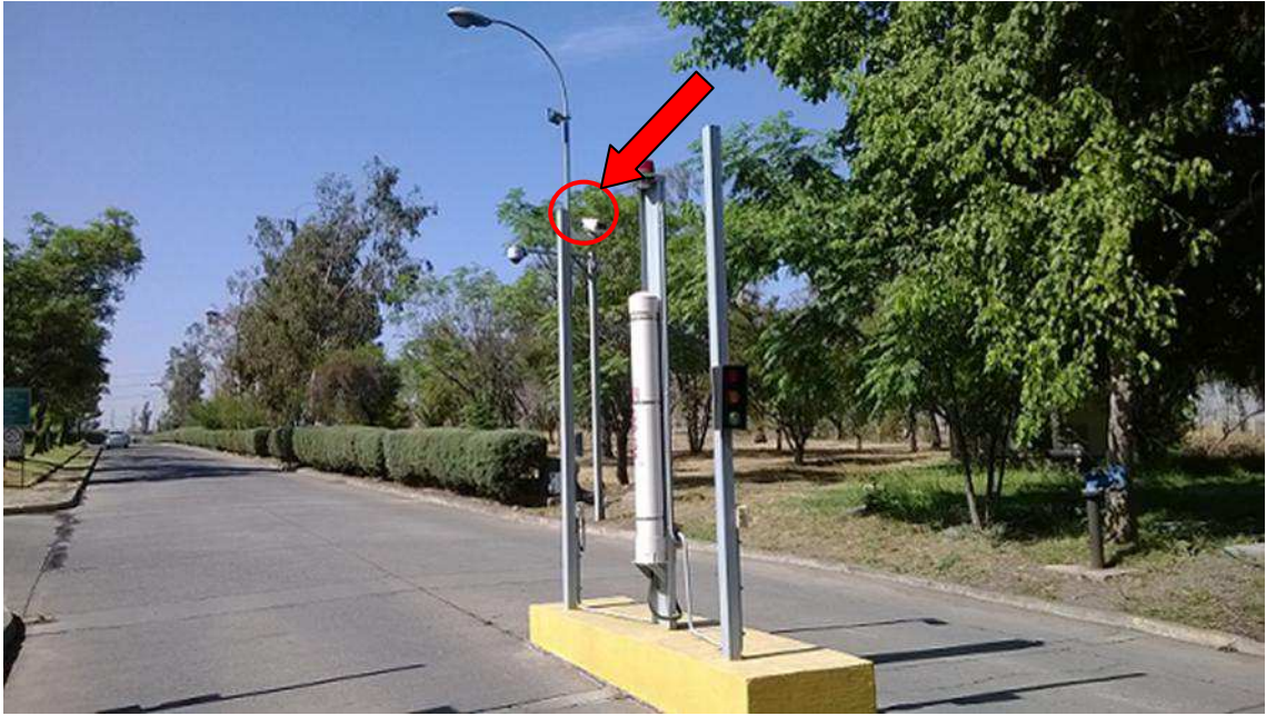
FIG. 8. Cámara Instalada en un pilar de soporte del Portal de Acceso al CEN La Reina
