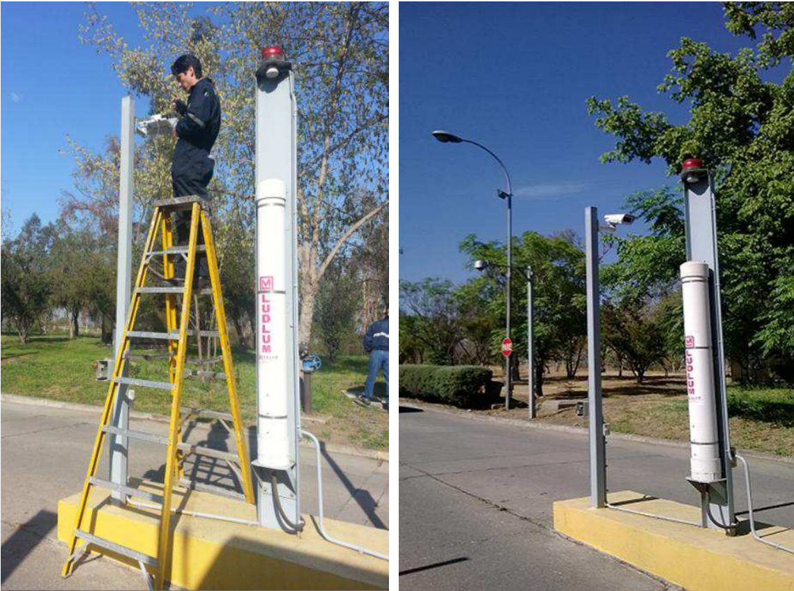
FIG. 7. Instalación Cámara IP
