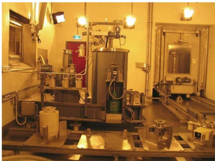
FIG. 24. Process hot cell HABOG (courtesy of COVRA N.V.).
