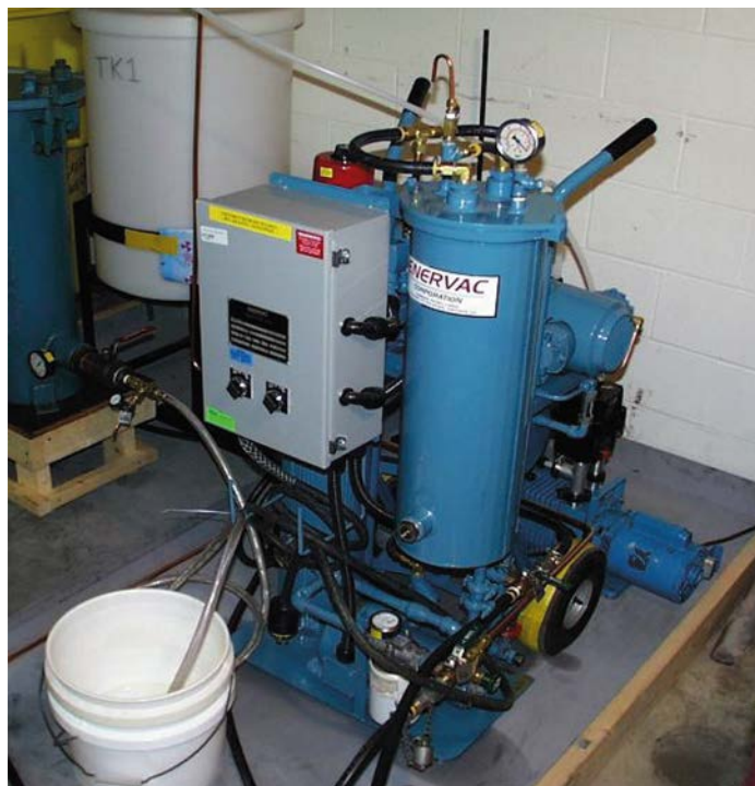
Fig. 10. Sistema de descontaminación de aceites: unidad de desgasificación en vacío y columna de alúmina activada (cortesía de Kinectrics).
