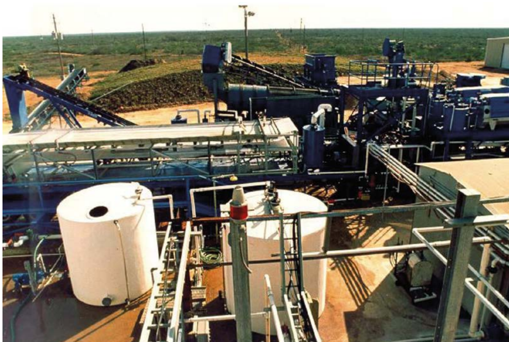
Fig. 7. Sistema de lavado de suelos (cortesía de EnergySolutions).
