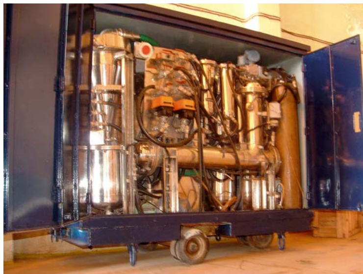
Fig. 3. Sistema de descontaminación de pisos montado en un carrito (cortesía de BARC).
