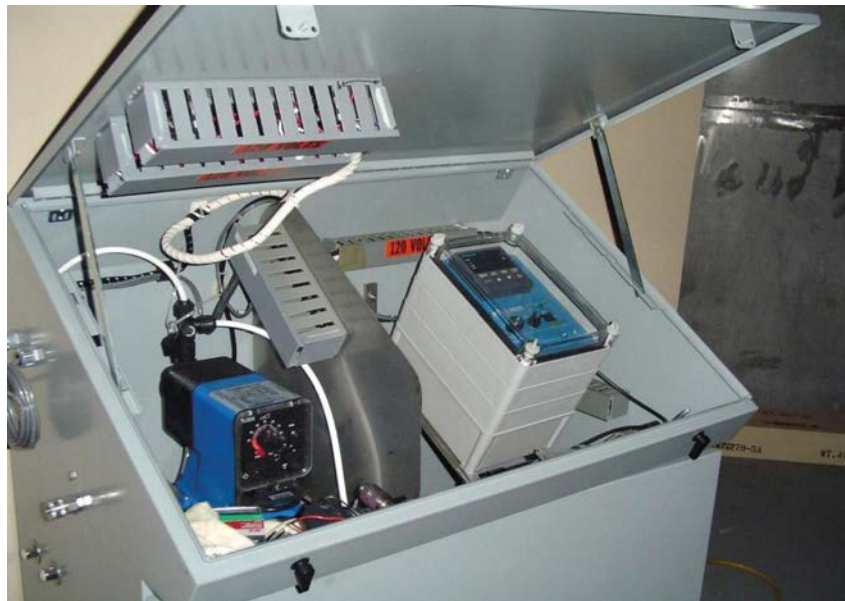
Fig. 6. Panel de control de un sistema típico de inyección continua de productos químicos (cortesía de EnergySolutions).
