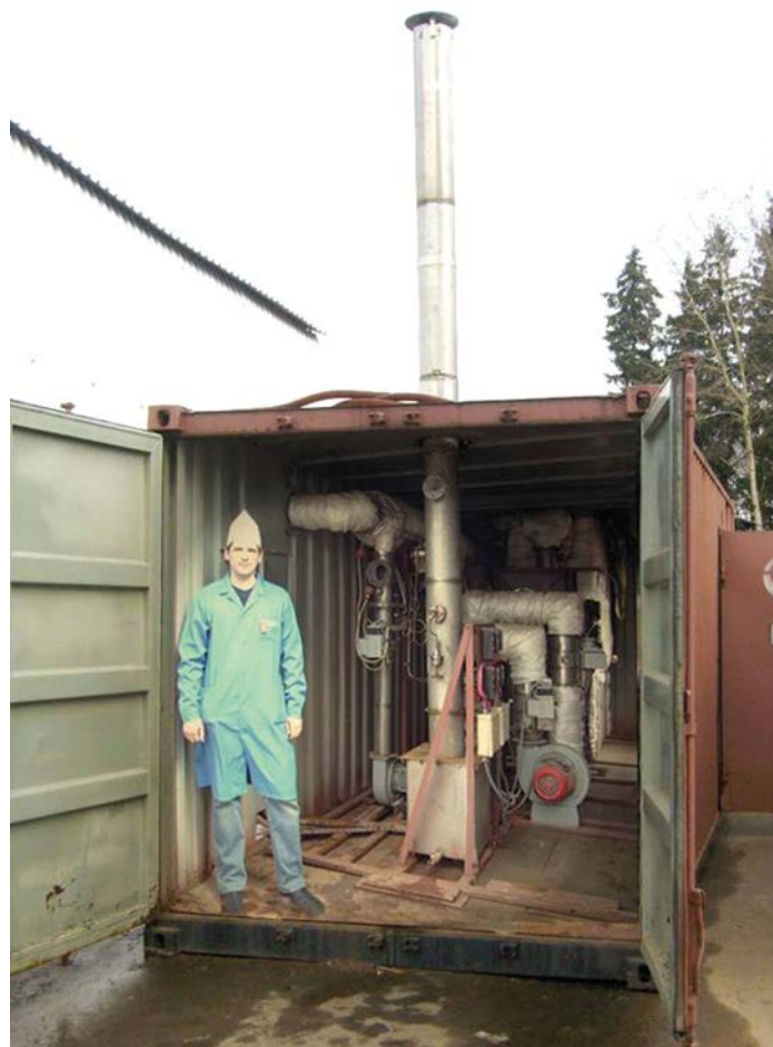
Fig. 21. Sistema móvil de tratamiento del gas expulsado (cortesía de MosNPO Radon).
