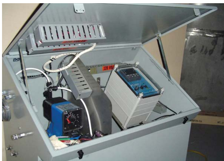
РИС. 6. Панель управления системой непрерывной подачи химических реагентов (с разрешения компании «Энерджи солишенз»).
