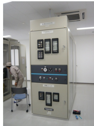
Metal Clad Switchgear
