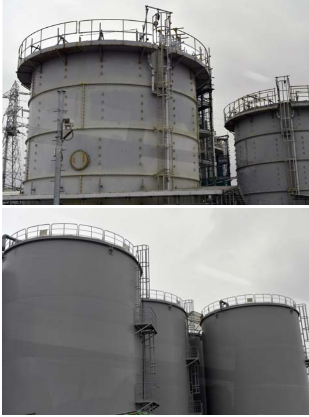
الشكل-47- صهاريج خزن المياه الملوثة السائبة في فوكوشيما: مشفهة بحواف رابطة (الجزء العلوي) وملحومة (الجزء السفلي). ياذن من شركة طوكيو القابضة للطاقة الكهربائية.
