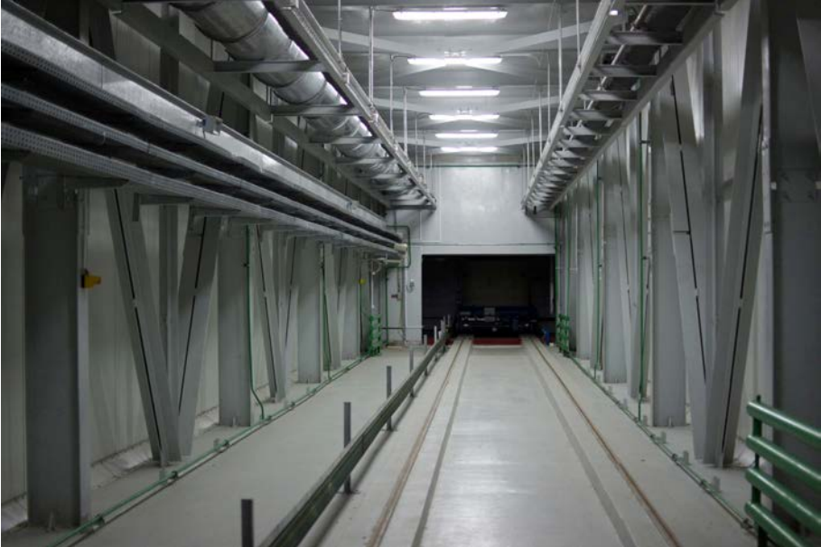
الشكل-23- رواق مخصص لنقل حاويات النفايات يُسَيَّر عن بُعد ويربط منشأة استرداد النفايات المشعة الصلبة في تشرنوبل بالمجمع الصناعي للتصرف في النفايات المشعة الصلبة. بإذن من المؤسسة الحكومية المتخصصة "محطة تشرنوبل للقوى النووية".
