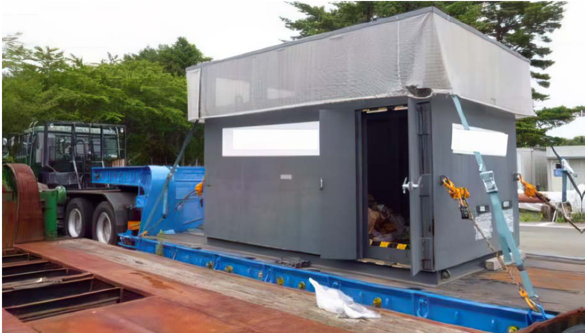
РИС. 30. Мобильная система очистки загрязненной воды в главной траншее АЭС «Фукусима-дайити». Публикуется с разрешения Токийской электроэнергетической компании.
