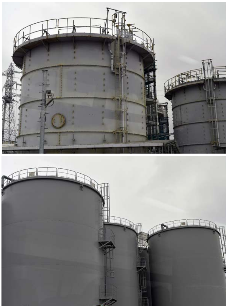
РИС. 47. Резервуары для бестарного хранения загрязненной воды на АЭС «Фукусима-дайити»: фланцевые (вверху) и сварные (внизу). Публикуется с разрешения Токийской электроэнергетической компании.
