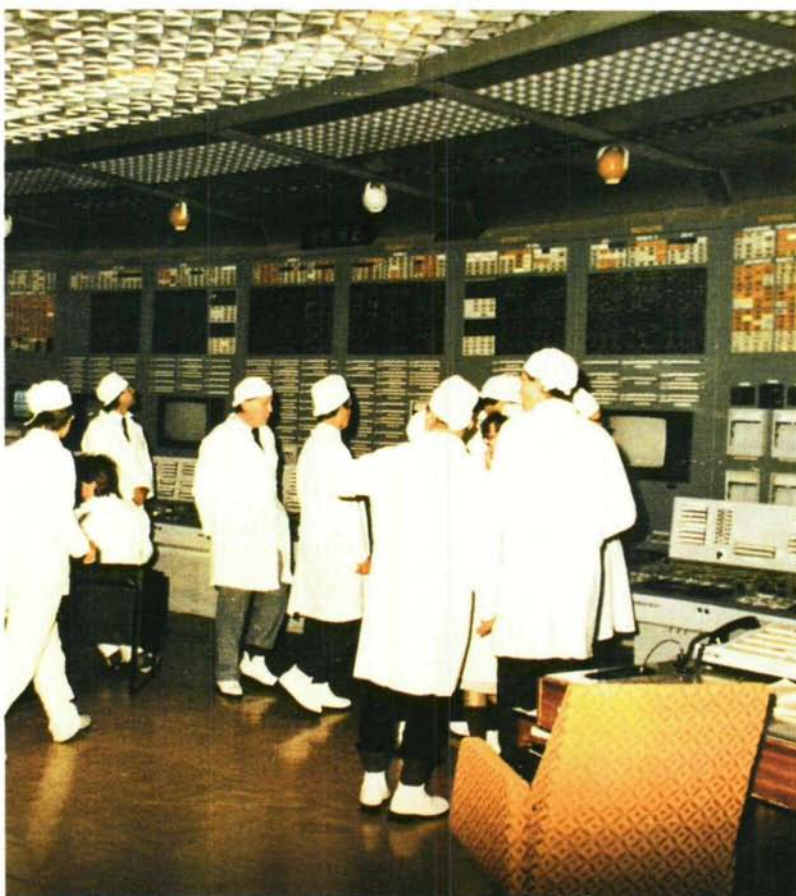
Группа экспертов МАГАТЭ обследует помещение блочного щита управления Игналинской АЭС в Литве
